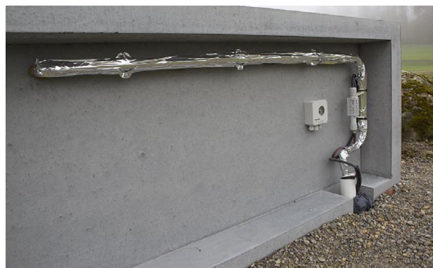
Rückwand bei der Ausführung «frostsicher», nach der Installation der Sanitärteile, vor dem Einbringen des Isolationsmaterials und der Befestigung der Rückwand. Diese Arbeiten werden vor Ort von einem zu beauftragenden Sanitärfachmann ausgeführt.
